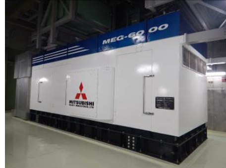
ガスタービン発電機外観
