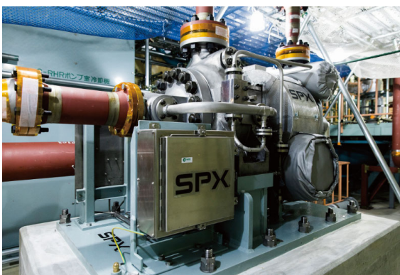
高圧原子炉代替注水ポンプ
