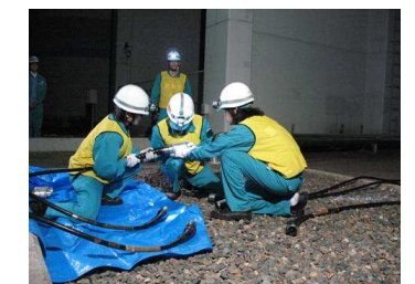
夜間訓練（電源供給訓練）の様子
