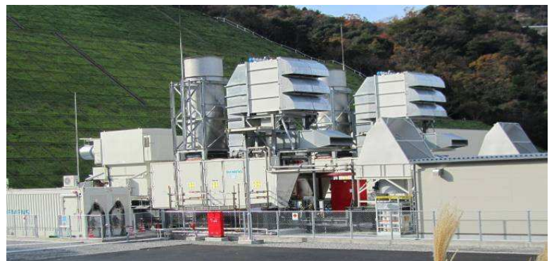
据付後のガスタービン発電機
