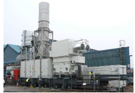
同型のガスタービン発電機 （当社が設置する発電機とは外観がやや異なる）
