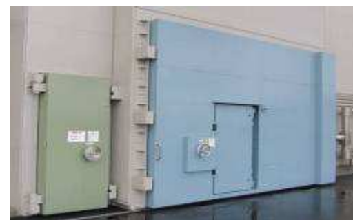
3号機建物外壁に設置した水密扉
