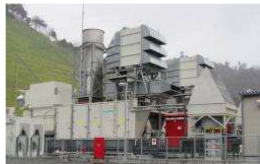
運用を開始したガスタービン発電機
