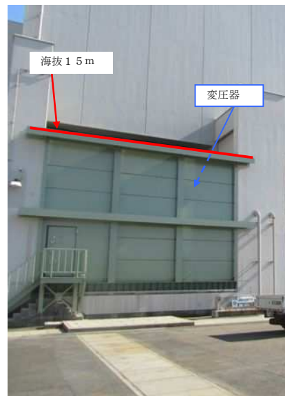
2号機変圧器エリアの防水壁
