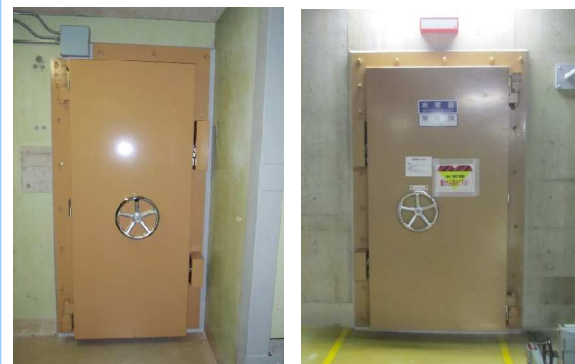
2号機建物内に設置した水密扉
