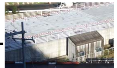
輪谷貯水槽×2槽
