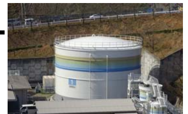
2号ろ過水タンク×1基
