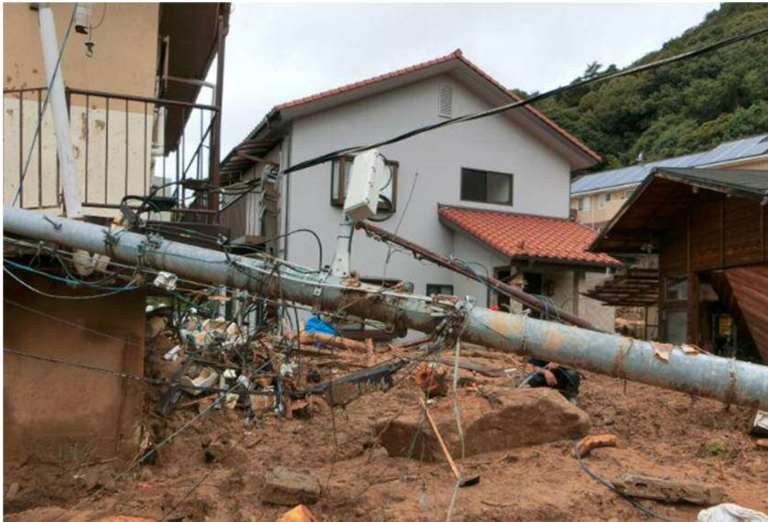
<倒壊した電柱②（広島県広島市安芸区）>
