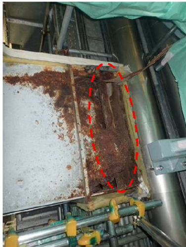
腐食孔 約 100cm×約 30cm
