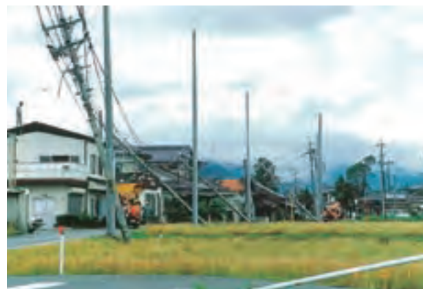
台風19号による電柱折損(山口市)
