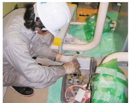
点検時期の超過が考えられる機器については、健全性を確認するため点検を行っています。
