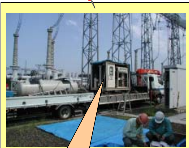
SF 6 ガス回収装置
