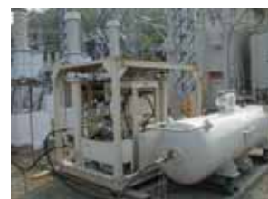
SF 6 ガス回収装置
