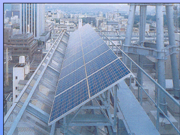
太陽光発電設備
