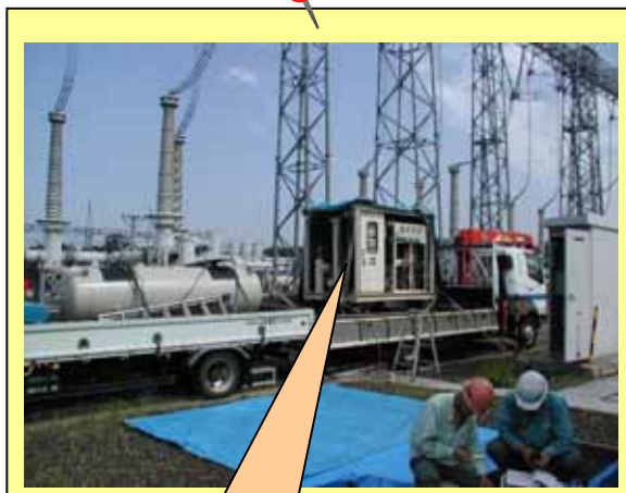
SF 6 ガス回収装置
