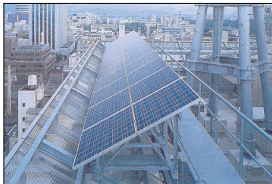
太陽光発電設備
