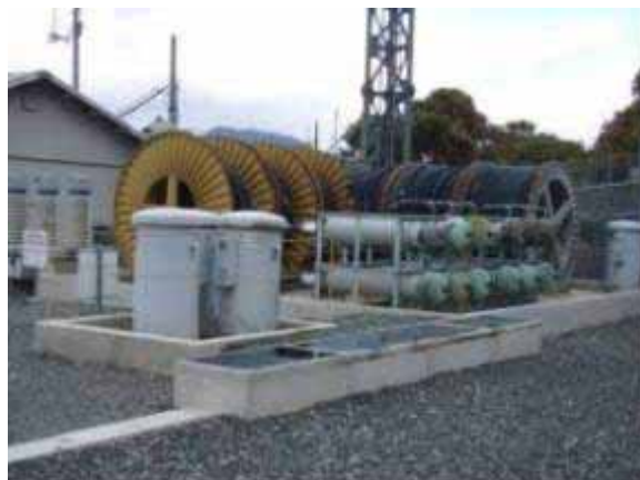
防油堤及び油水分離層を設けて保管している例
