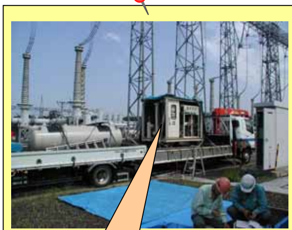
SF 6 ガス回収装置
