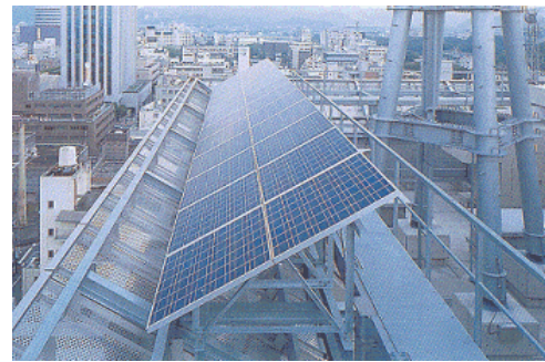
太陽光発電設備
