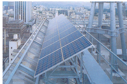
太陽光発電設備
