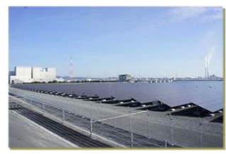
宇部太陽光発電所
