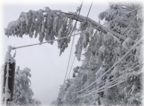
設備被害状況
