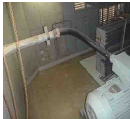
電動機及び電線管
