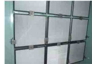
フィルタ（例）：中央制御室空調換気系 外気処理装置 フィルタ
