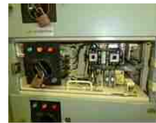
コントロールセンタ（気中遮断器）
