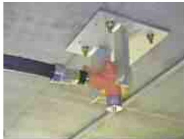
水素濃度検出器
