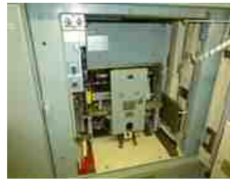
ロードセンタ（気中遮断器） 屋内の遮断器の例
