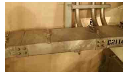
金属電線管及び蓋付ケーブルトレイ
