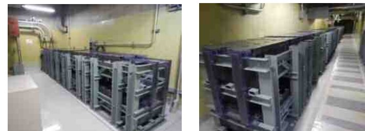
蓄電池設置エリアの設置状況
