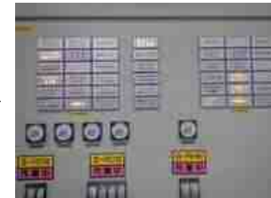
中央制御室制御盤（警報表示）
