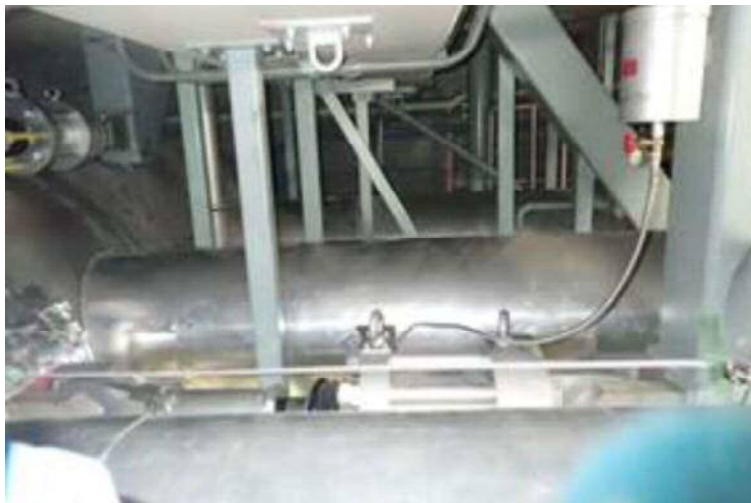
主蒸気ヘッド周辺 (600A)
