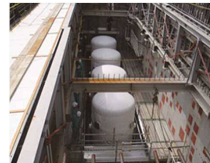
フィルタ付ベント設備
