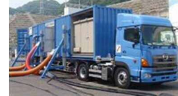
移動式代替熱交換設備
