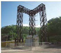
第2-66kV開閉所
