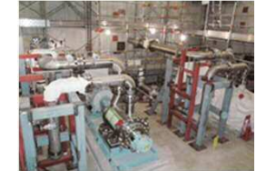
低圧原子炉代替注水ポンプ
