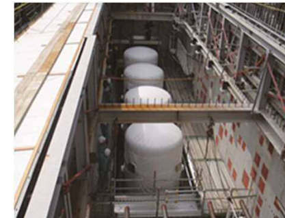
フィルタ付ベント設備
