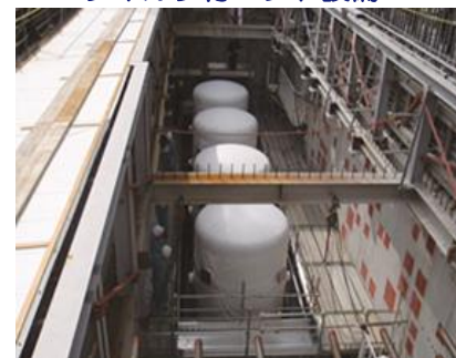
フィルタ付バント設備
