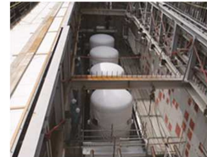
フィルタ付ベント設備
