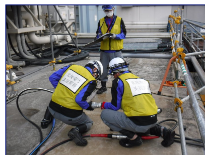
他電力と協働した電源確保訓練
