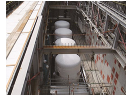
フィルタ付ベント設備
