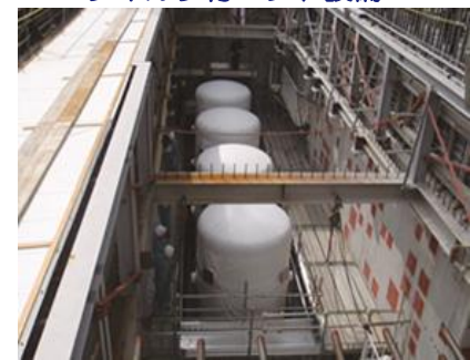
フィルタ付ベント設備
