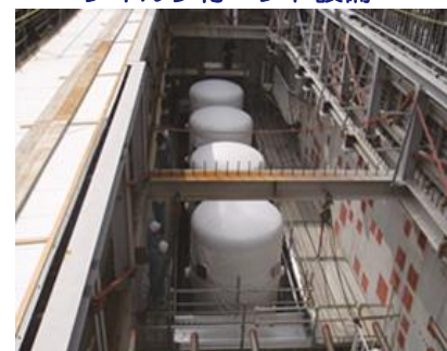
フィルタ付ベント設備
