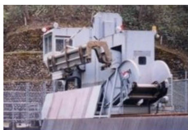
取水口除塵機全景
