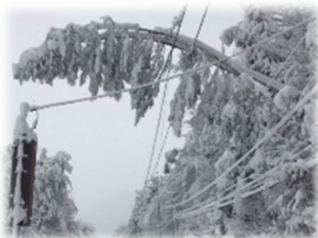
設備被害状況
