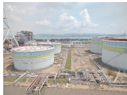
燃料油タンク
