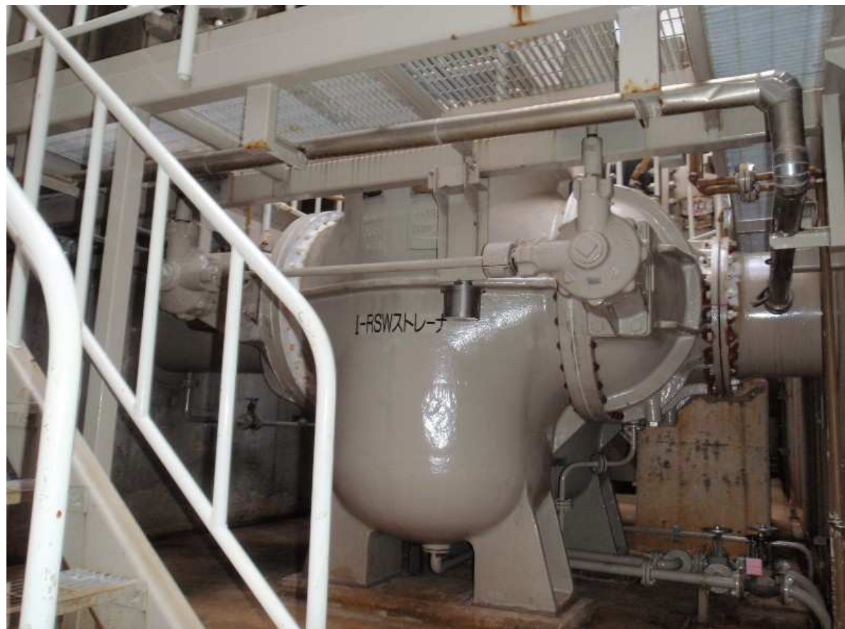
【原子炉補機海水ストレーナ(2号機)】
