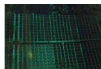
発電所(燃料プール)
