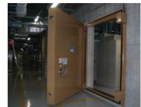
建物内側に設置した水密扉
