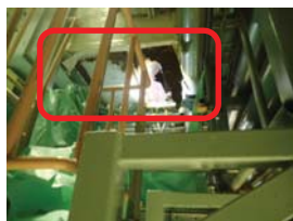
【腐食孔(約100cm×約30cm)】
