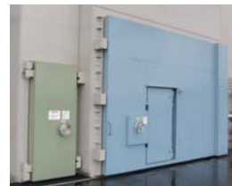
建物外側に設置した水密扉
