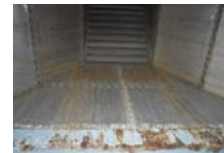
ダクト内面の腐食
