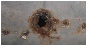
腐食孔の一例(直径1cm程度)
