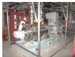
常設低圧代替注水設備設置状況 (平成29年5月)
