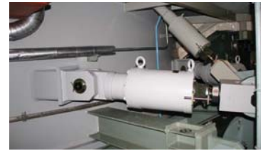
地震の揺れを低減するダンパー等を設置
