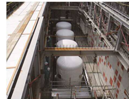
フィルタ付ベント設備
