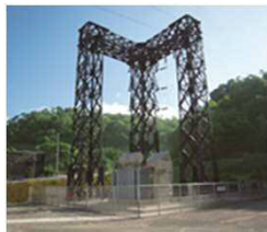
緊急用開閉所
