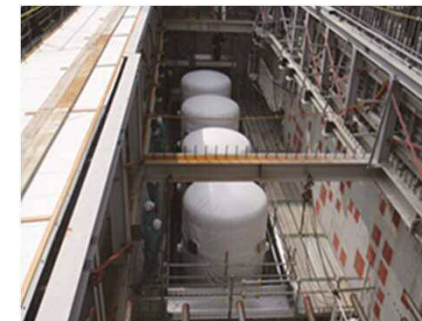
フィルタ付ベント設備
