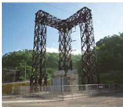
緊急用開閉所
