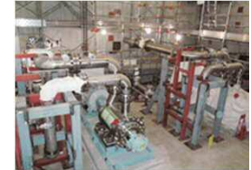
低圧原子炉代替注水ポンプ
