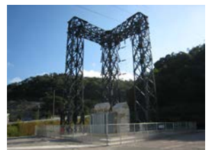
66kV受電設備
