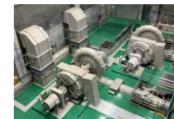
豊川発電所(リパワリング後)
