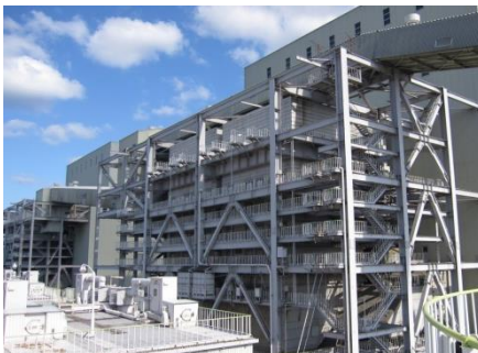
排煙脱硝装置
