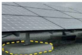
太陽光パネル基礎ブロック
