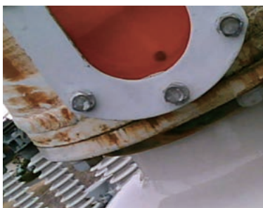
写真4 OCBブッシングの油面計撮影
