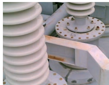
写真7 配電用変圧器上部発錆状況撮影
