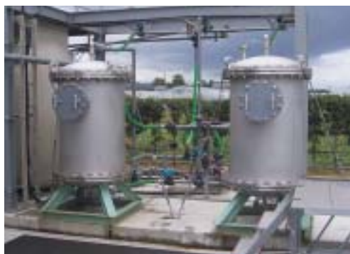
農業集落排水処理施設に設置されたリン除去装置 (写真提供：イズコン)
