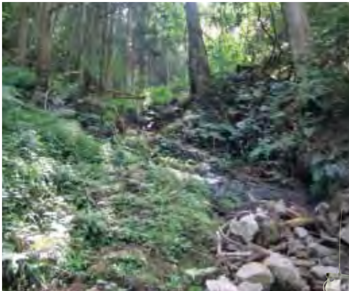
上流の土石流の通り道にワイヤーを張る 写真提供:シンク・フジイ
