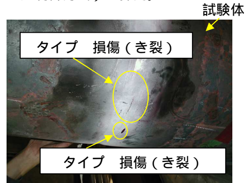
試験体下部の損傷状況
