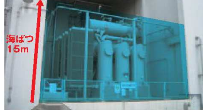
[写真②] 電気設備の防水壁
