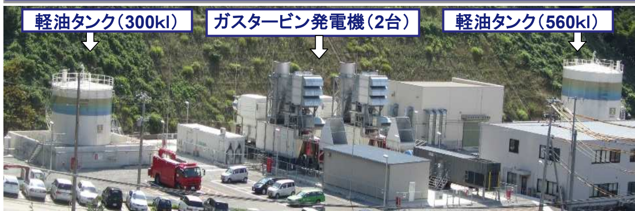
緊急用発電機 設置(海拔44m)
