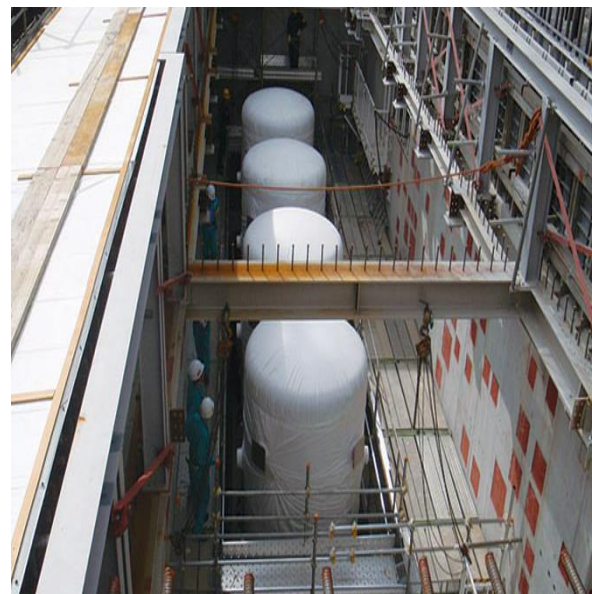
フィルタ付ベント設備
