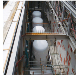
フィルタ付ベント設備
